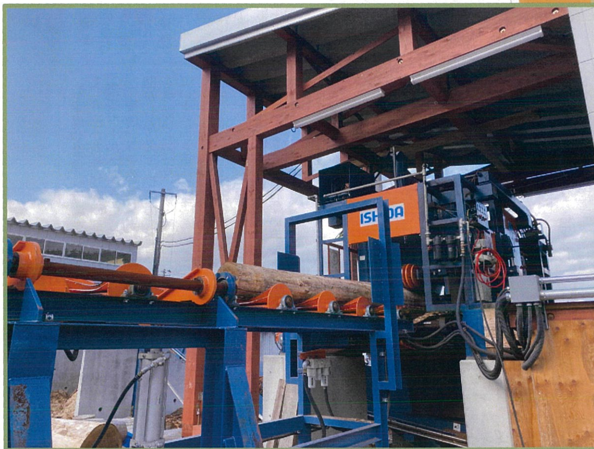
平成31年4月導入 リングバーカー（剥皮施設）
